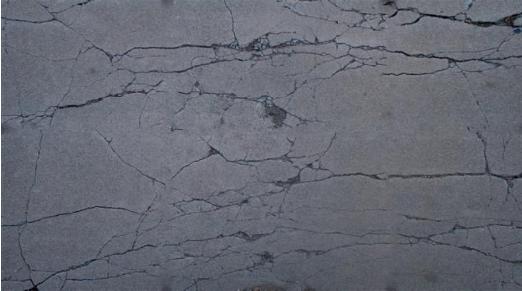
Şekil 28: Çevresel etkilere maruz kalmış beton
