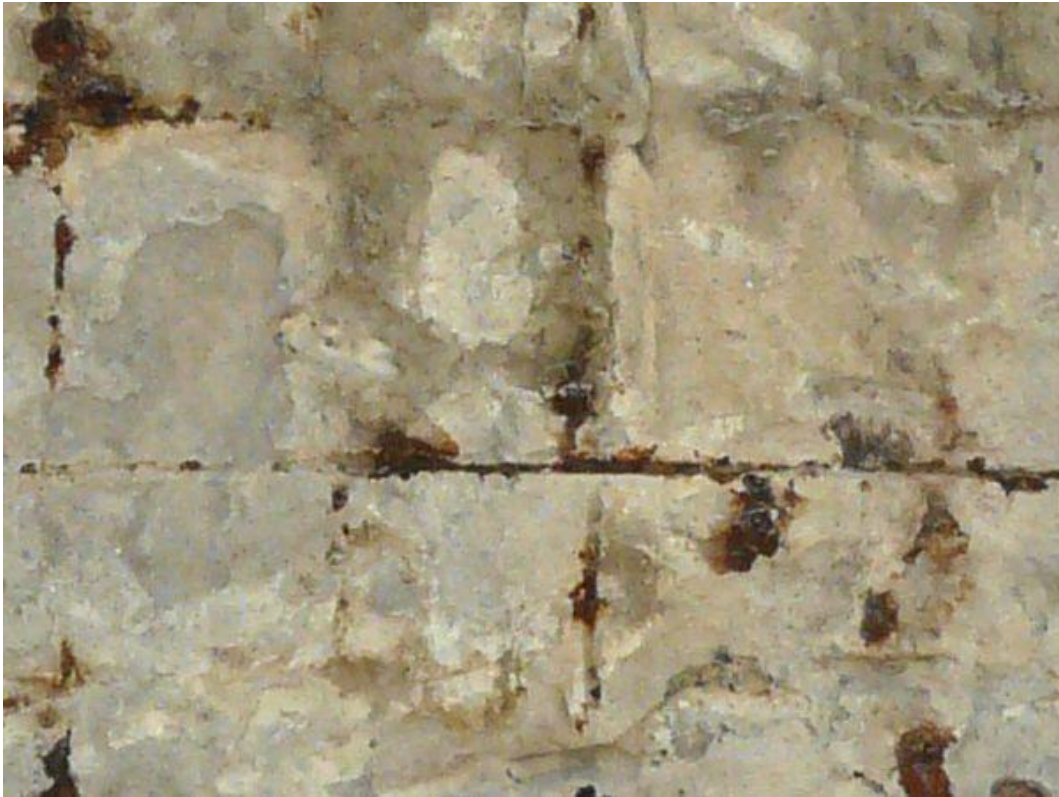
Şekil 26: Aşınmaya uğramış beton örneği
