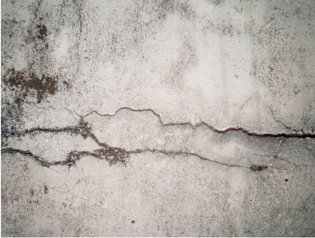
Şekil 27: Çevresel etkilere maruz kalmış beton örneği
