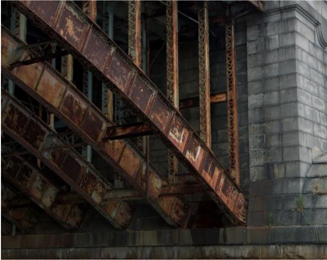
Şekil 31: Korozyon etkisiyle yıpranmış çelik köprü
