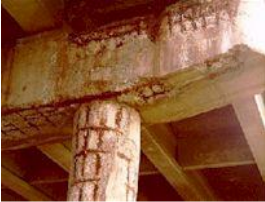
Şekil 34: Dış etkilerden hasara uğramış betonarme köprü ayağı
