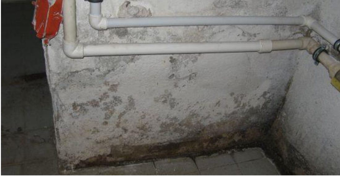
Şekil 30: Korozyon tehlikesi, betona etkileri
