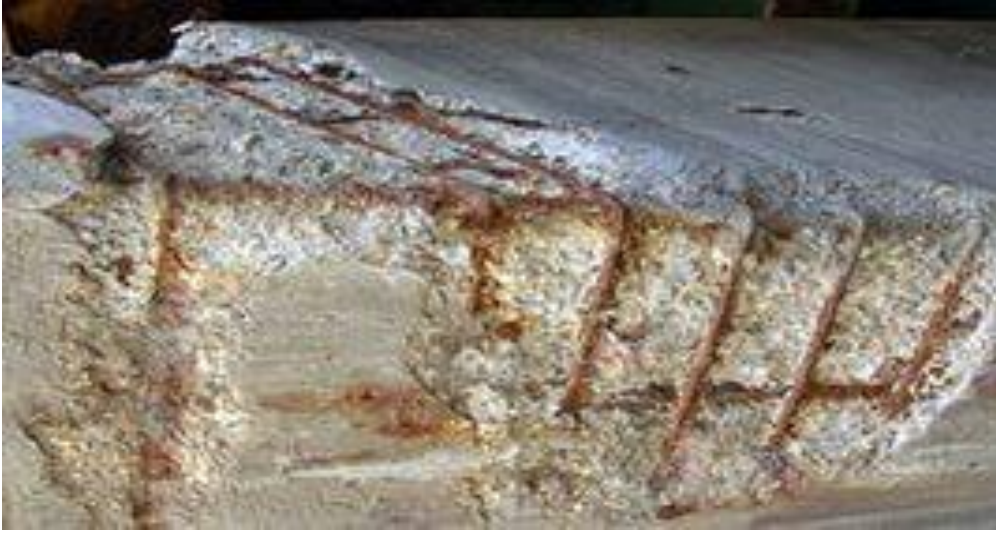
Şekil 32: Kiriş elemanında korozyondan kaynaklı deformasyon
