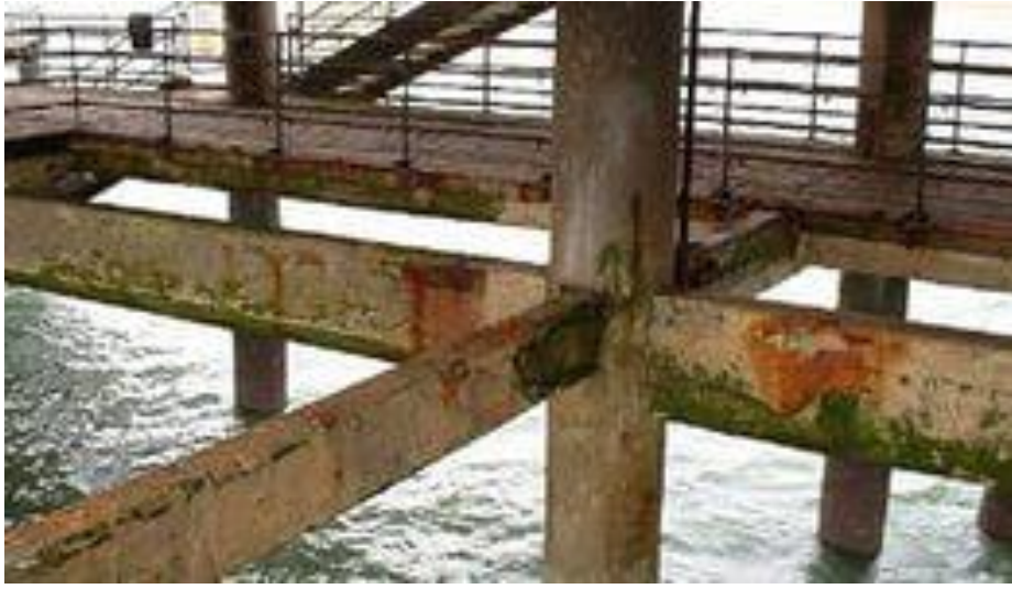
Şekil 33: Deniz suyu etkisinden, hasara uğramış, betonarme yapı
